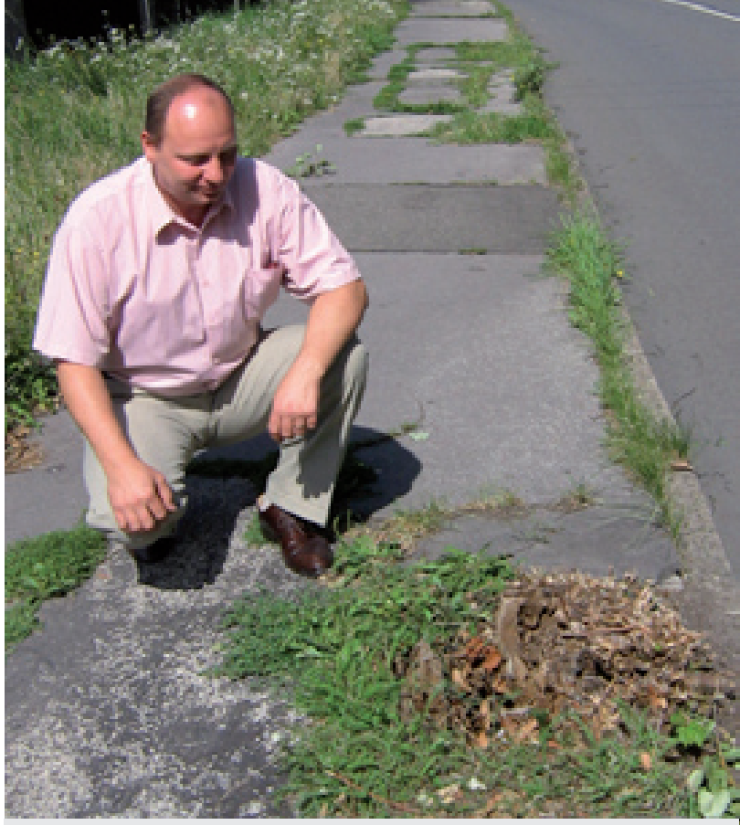
NEBEZPEČÍ/ Chodníky na Hladnovské ulici v Muglinově jsou v dezolátním stavu. Městský obvod Slezská Ostrava chce proto začít s jejich opravami co nejdříve. Na snímku místostarosta Radim Šlachta. Foto/Marie Stypková
