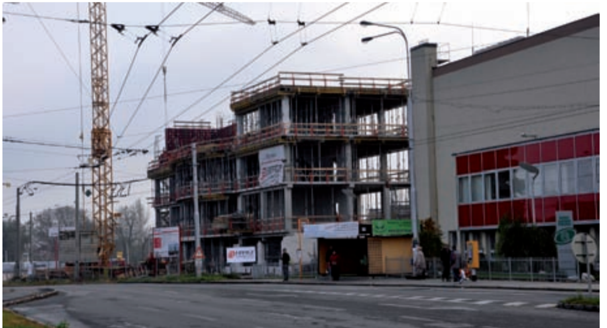
CO TAM BUDE? Na Michálkovické ulici je stavba nové administrativní budovy Revírní bratrské pokladny v plném proudu. FOTO/LUBOMÍR ČASNOCHA
