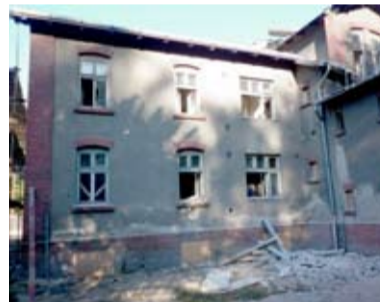
MINULOST. Dům byl před rekonstrukcí ve velmi špatném stavu.
