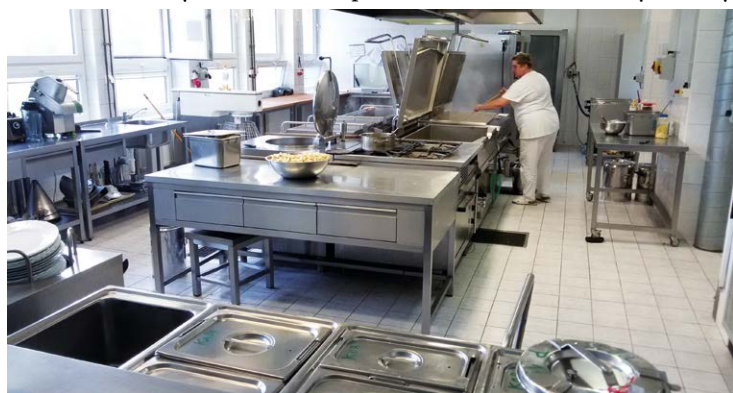
V NOVÉM. Moderní vybavení kuchyně ZŠ Bohumínská. Foto/ archiv
