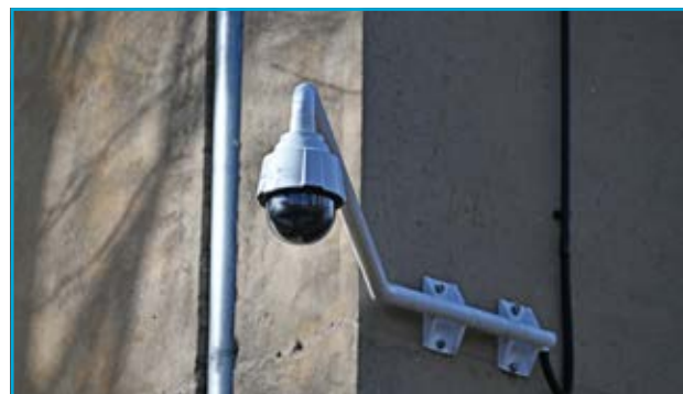
Starosta Richard Vereš, místostarosta Vladimír Lyčka a vedoucí oblasti Městská policie Slezská Ostrava Marcel Pažický na problematickém místě Muglinovské ulice, kde byla nainstalována nová bezpečnostní kamera.
